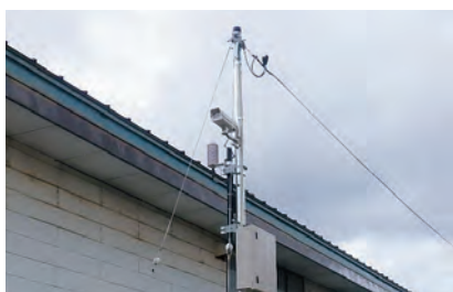
自社開発クラウド 降雪・積雪深計の施工状況 （長岡市中之島支所にて）
